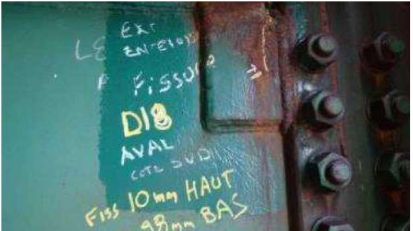
Des travaux urgents sur le pont Laviolette se font attendre. Photo : Ministère des Transports
